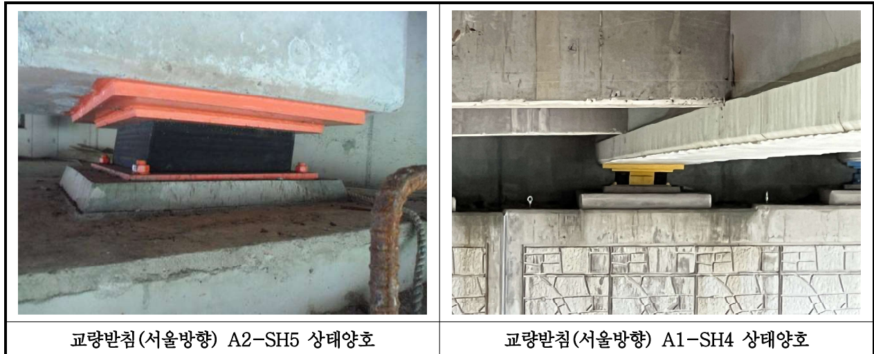
【사진 38.3.11】 교량받침(서울방향) 손상현황
