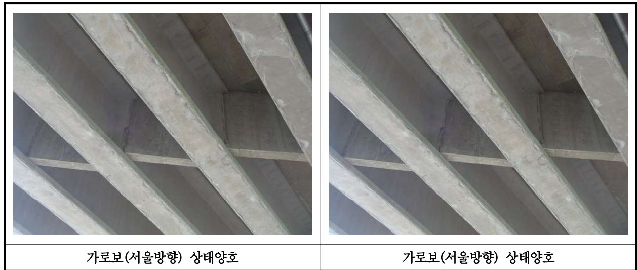
【사진 38.3.7】 가로보(서울방향) 손상현황
