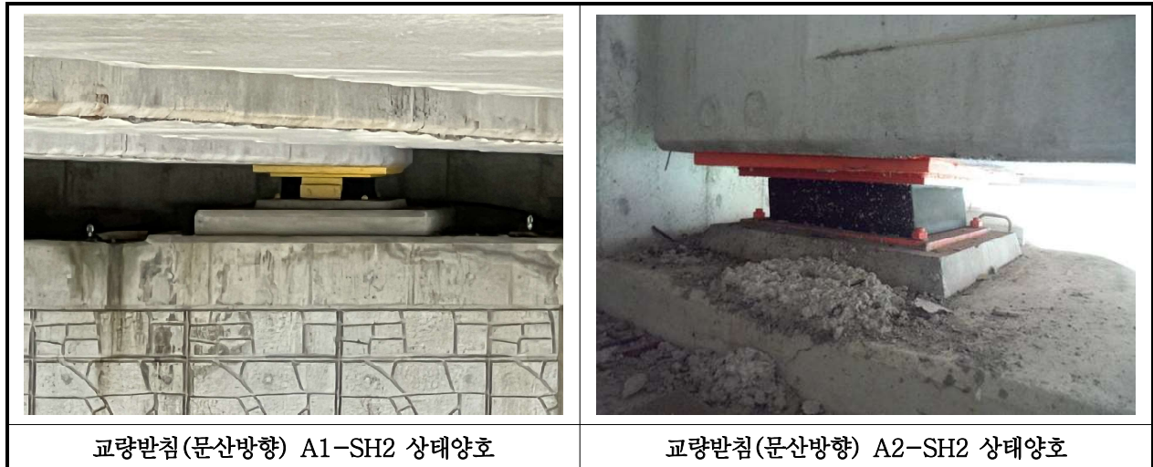
【사진 38.3.32】 교량받침(문산방향) 손상현황
