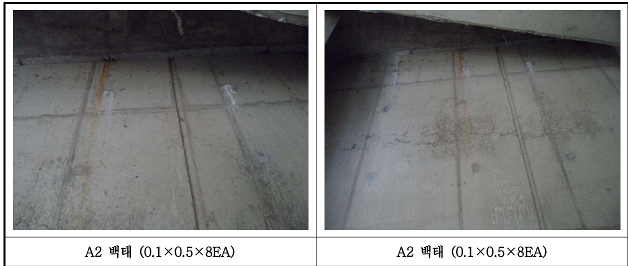
【사진 38.3.30】 교대(문산방향) 손상현황
