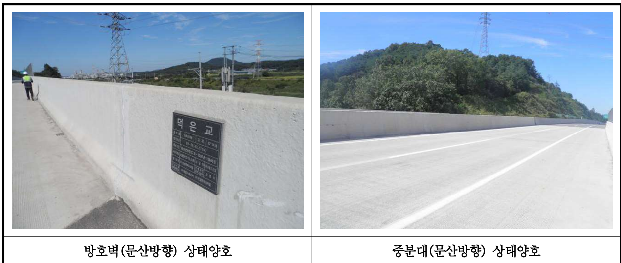
【사진 38.3.43】 방호벽 및 중앙분리대(문산방향) 손상현황
